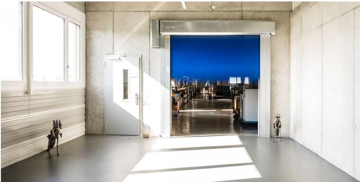
Schnellauftor V6030 SEL und Stahl-Feuerschutztüre STU-1
